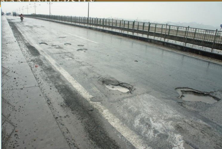
马房桥钢桥面铺装层病害
