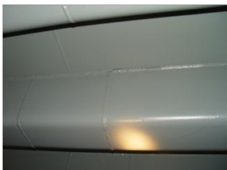
b) 纵肋与面板焊接处 裂纹
