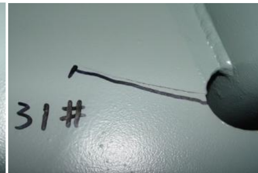
d) 隔板撕裂
