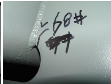
c) 纵肋与隔板焊 接处裂纹
