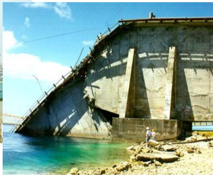
科罗巴岛桥垮塌
